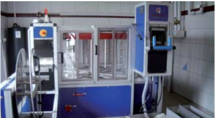
Abschirmungen gegen Nässe und den Wasserstrahl platzender Schläuche.
